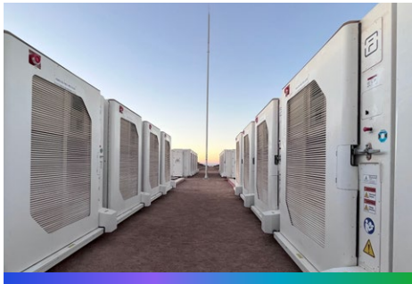
Baterías de almacenamiento Andes Solar II-B
